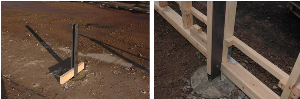
Figur 3 Det armerade betongfundamentet \text{Ø}400 \text{ mm} \times 1 \text{ 300 mm} med plattstål 10 \times 100 \times 1 \text{ 560 mm} . Den vertikala regeln fästs mellan plattjärnen med två genomgående bultar M12.
